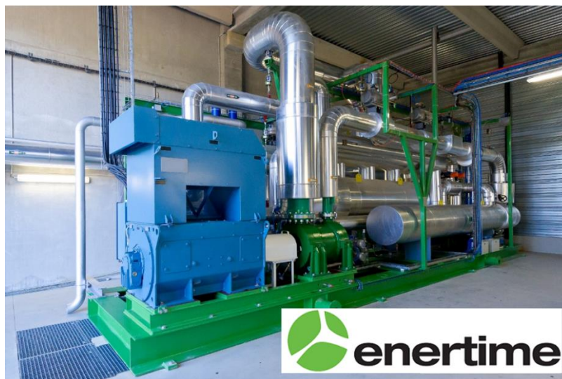
Exemple d'installation conçue et réalisée par Enertime, Montpellier 2013
